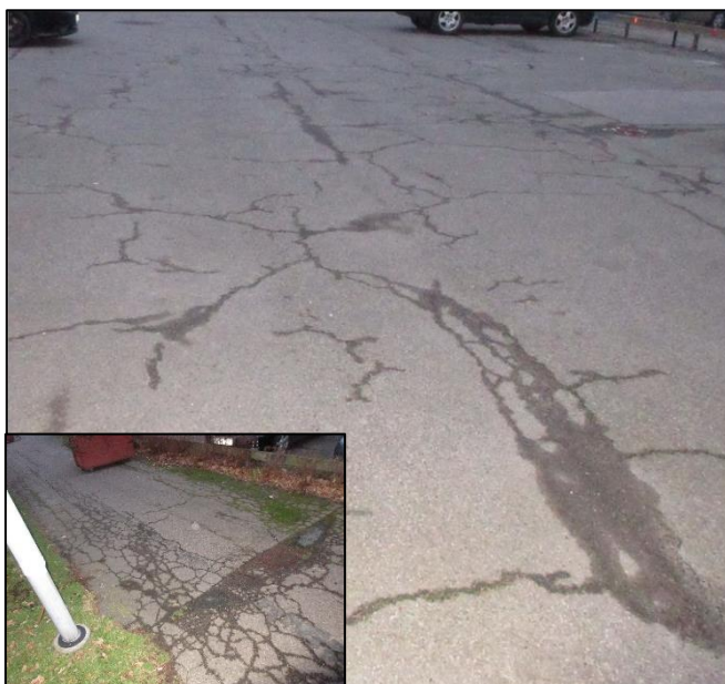
Sprucken beläggning, parkering och gångbana.
