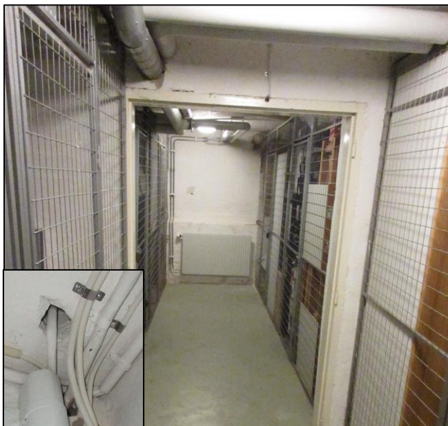
Källargång med troax-nät samt otäta genomföringar
