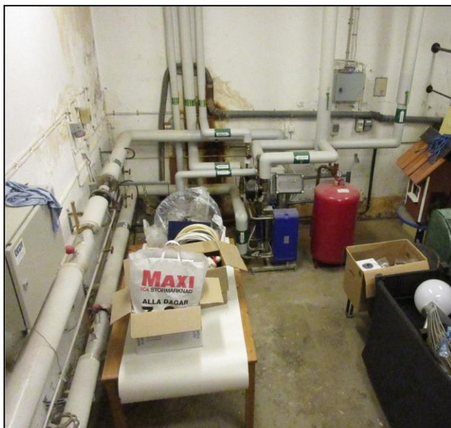
Pannrum med fjärrvärmväxlare
